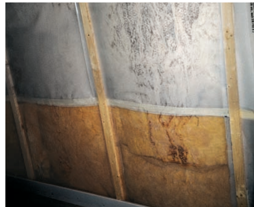
Kostean puun ja perinteisen höyrynsulkukalvon yhdistelmän aiheuttama vaurio.
