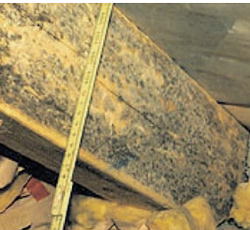
Homeen vaurioittamat kattopalkit.
